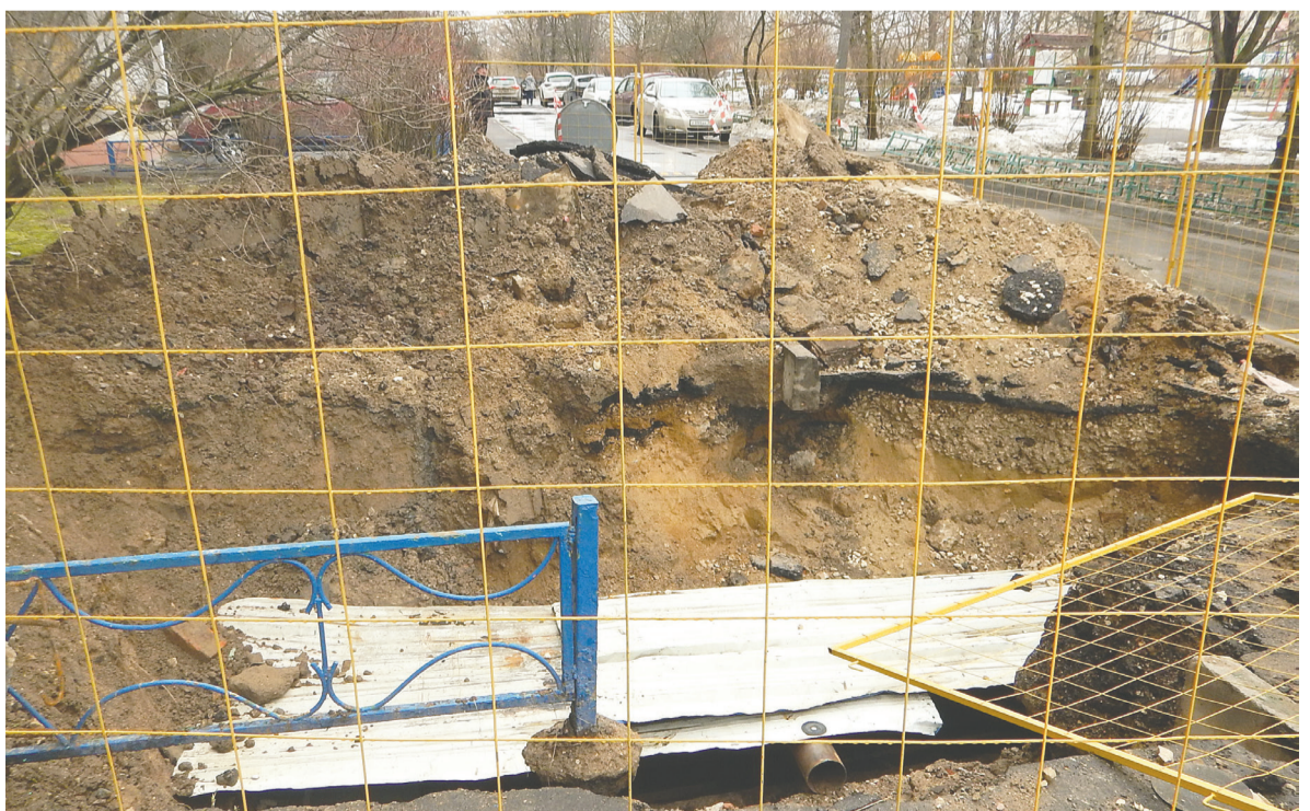
Лихачевское шоссе. Очередная авария на теплотрассе.
